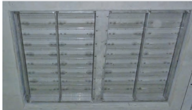
Sekcja klap tunelowych od strony tunelu
